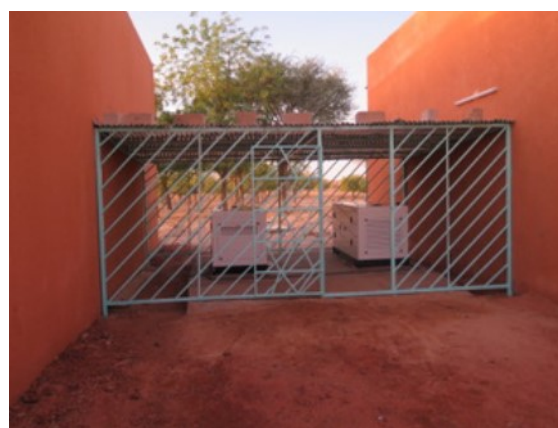
Générateurs de secours
