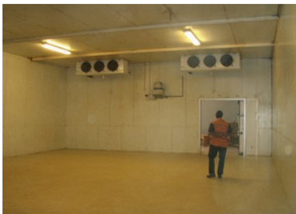
Chambre froide positive de grande capacité 400 tonnes
